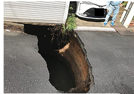
(2020年10月調布市の陥没事故)
