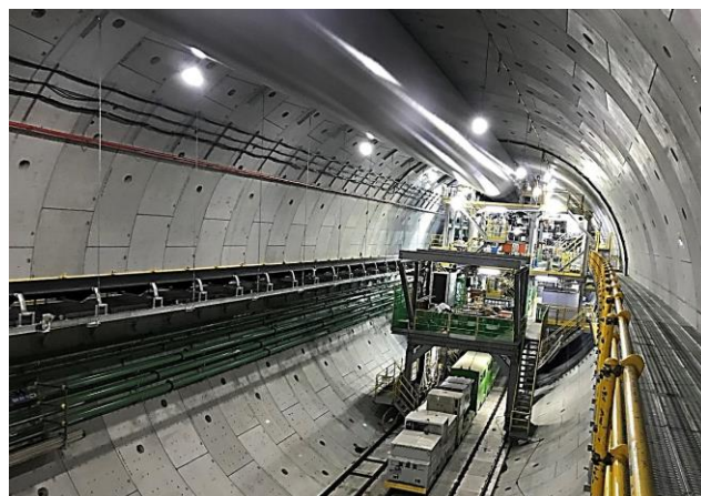
東京外環道大深度工事(酸欠気泡の発生?) (写真は3/25外環プロジェクトHPから)
