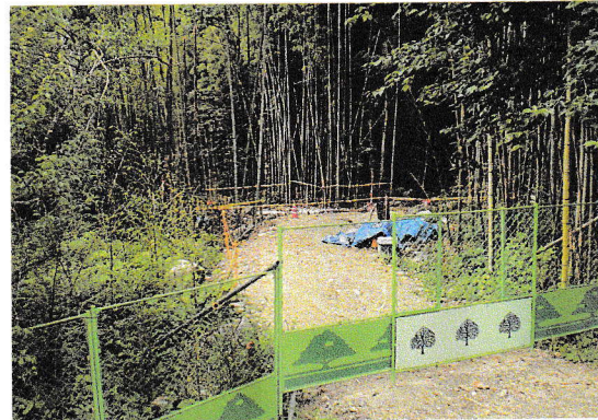
崩落現場は竹林の中
