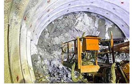
伊那山地トンネル事故（写真JR東海）
