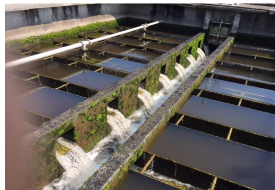
取水継続すべきだった 生田浄水場
