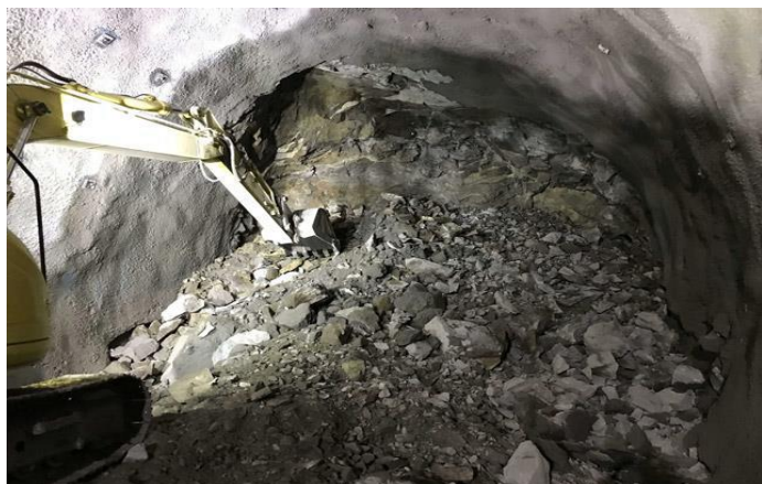
11月8日長野県 豊丘村 坂島工区 斜坑トンネルの事故現場
